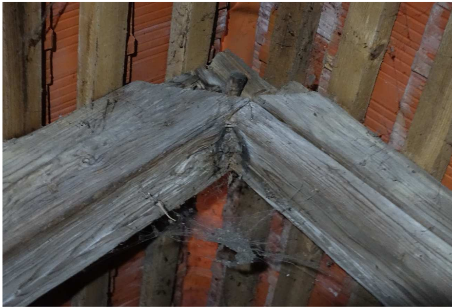
Abb. 4: Scherzapfen am Firstpunkt; die Absätze stammen von ehem. Blattsassen an den gekappten Enden.
