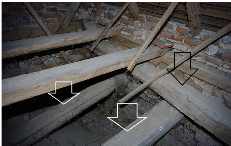
Abb. 12: Tiefer liegende Deckenbalken über dem Gewölbe (weiße Pfeile) u. Längs-Zugbalken (Ankerbalken; schwarzer Pfeil).
