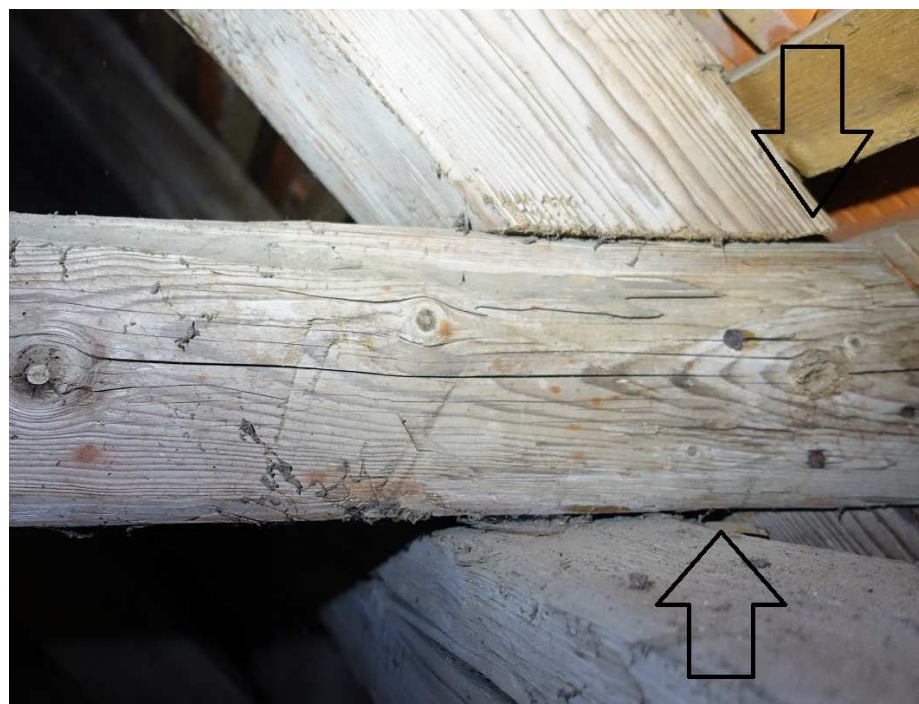
Abb. 5: Kehlbalken-Anschluss an den südlichen Sparren im Gespärre 14 von West: die Blattsasse ist nachgeschnitten (Pfeile), der Kehlbalken mit Holznagel (mittig) wurde mit Industrienägeln nachgenagelt.
